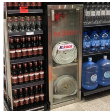
Abrigo para Hidrante
