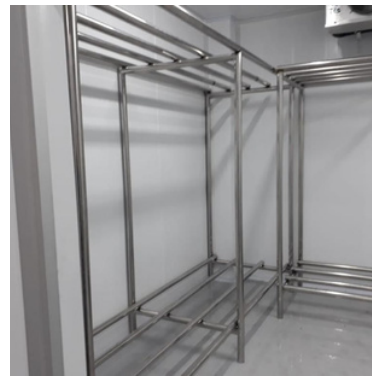
Gancheira interna de câmara frigorífica
